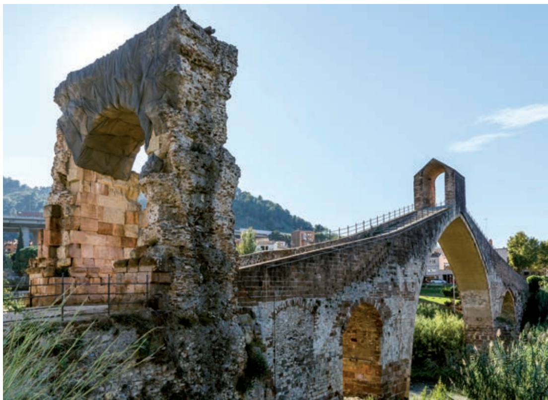
Vista panoràmica de l'estat actual del Pont del Diable. Fotografia de: Quim Roser.
