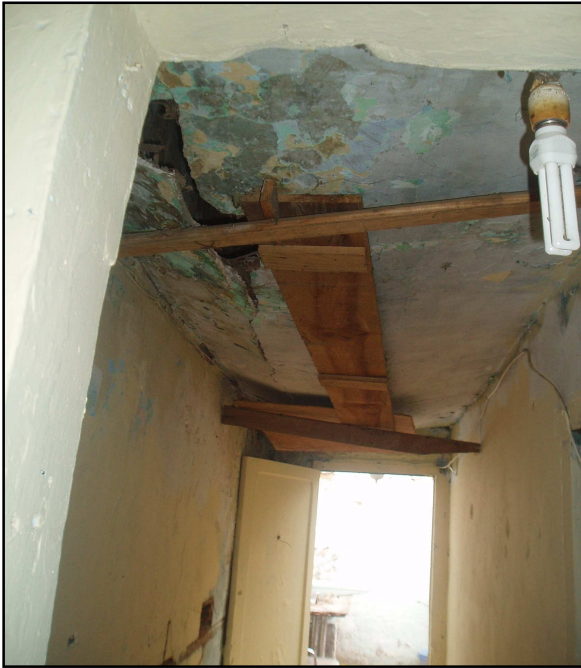
Passadís amb perill d'esfondrament
