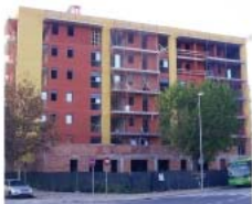
Uno de los bloques de pisos que se están terminando de construir en la Av. Remolar
