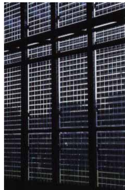
La façana de l'edifici està coberta amb 108 mòduls fotovoltaïcs multifuncionals transparents formats per cèl·lules solars de silici policristal·lines. A la fotografia, vista interior de la façana.
